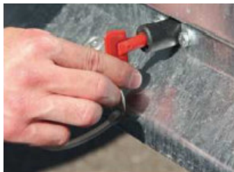
Bild 6: Hauptschalter auf AUS gestellt
